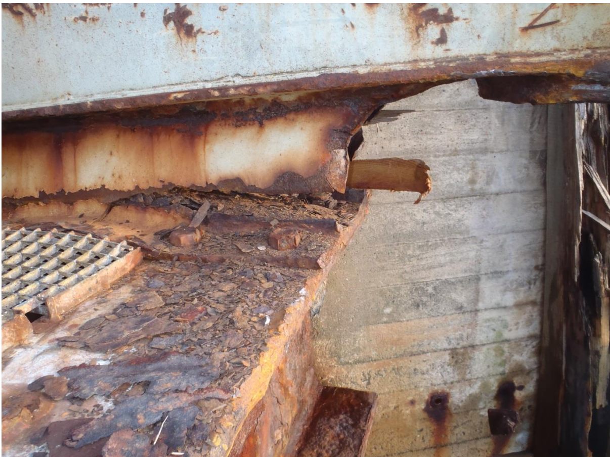
Bild 4: Korrosion i färjefästets balkar.
