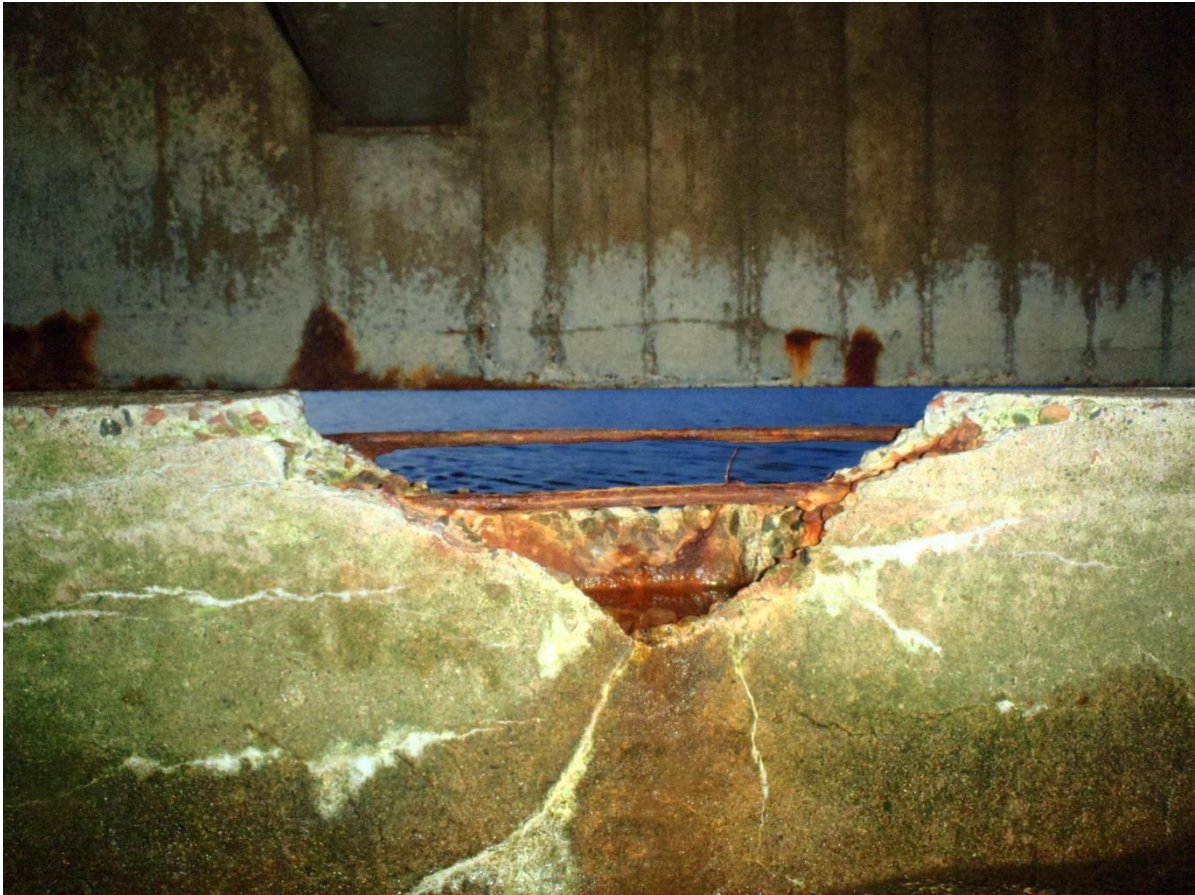
Bild 21: Betongskada i vågbrytare mellan stöd.
