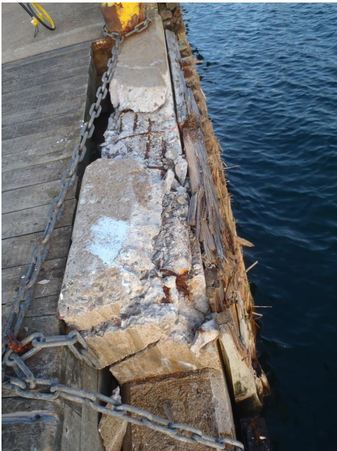
Bild 12: Betongskada vid pirände.
