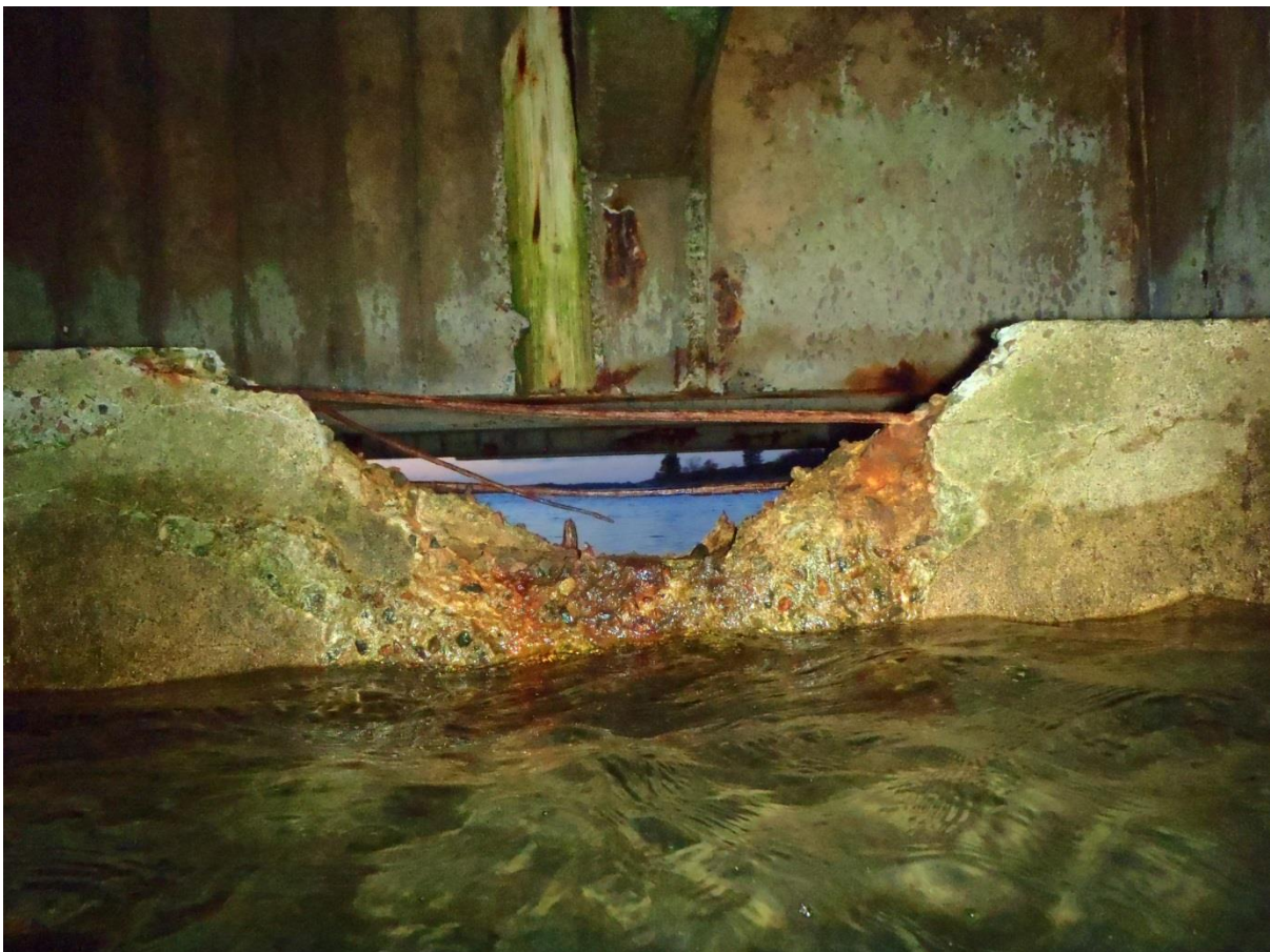
Bild 22: Betongskada i vågbrytare mellan stöd.
