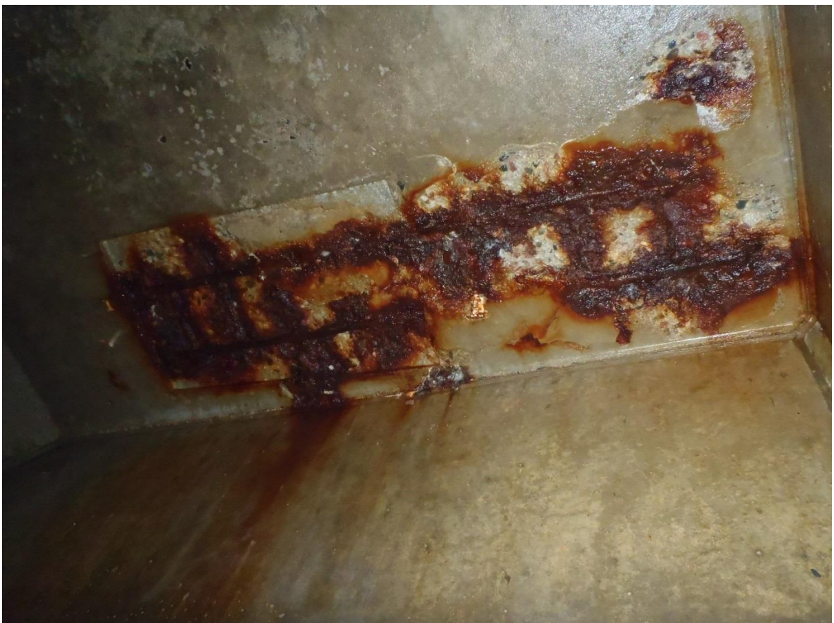
Bild 16: Armeringskorrosion och spjälkningar i pirdäckets underyta.
