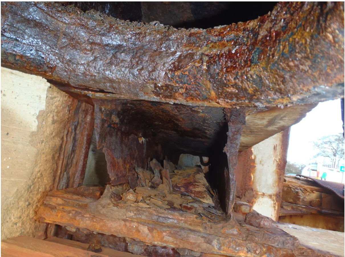
Bild 2: Korrosion i färjefästets balkar.
