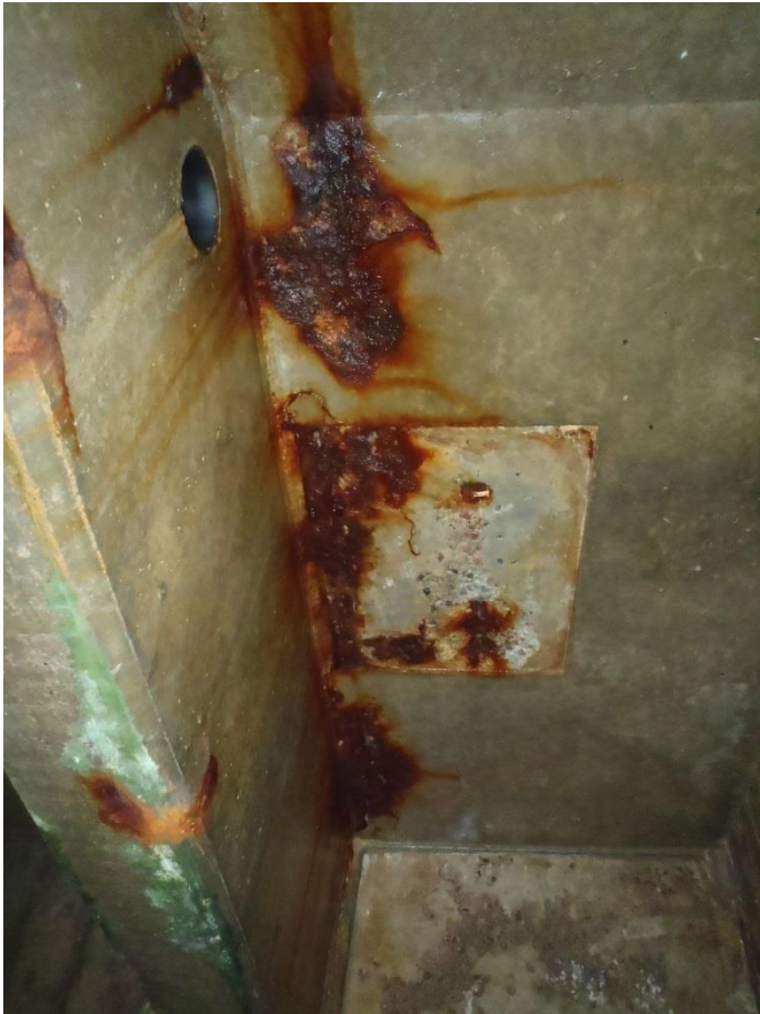
Bild 15: Armeringskorrosion och spjälkningar i pirdäckets underyta.
