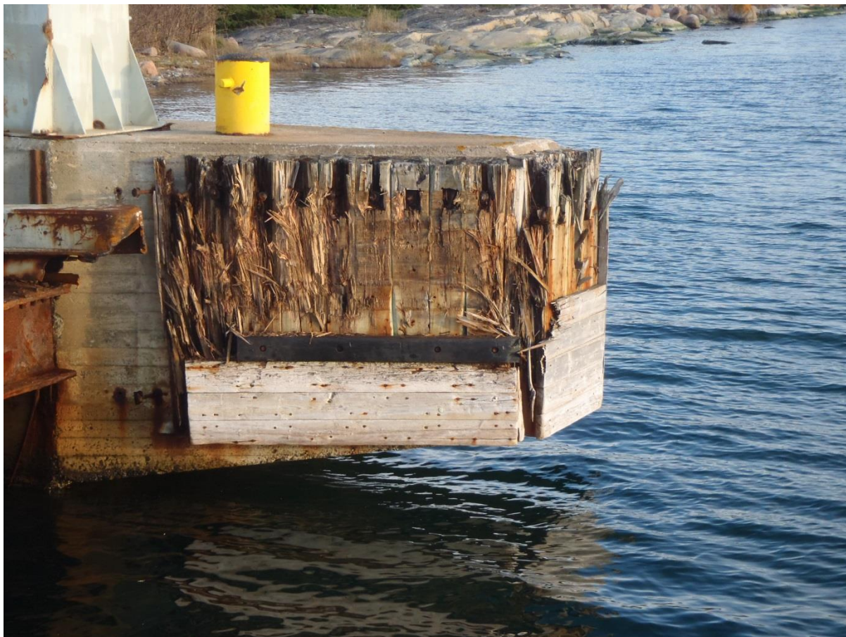
Bild 7: Utsliten träinklädnad vid yttre betongstöd.
