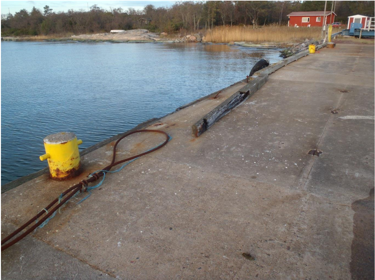
Bild 13: Skadat och murket avkörningsskydd på piren.
