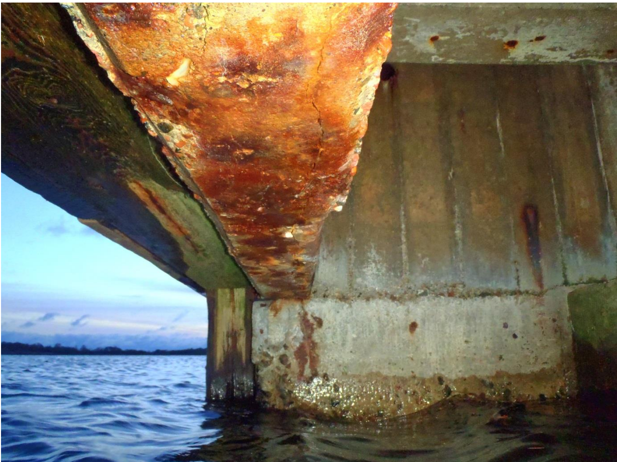
Bild 18: Armeringskorrosion och spjälkningar i pirdäckets huvud- och tvärbalkar.
