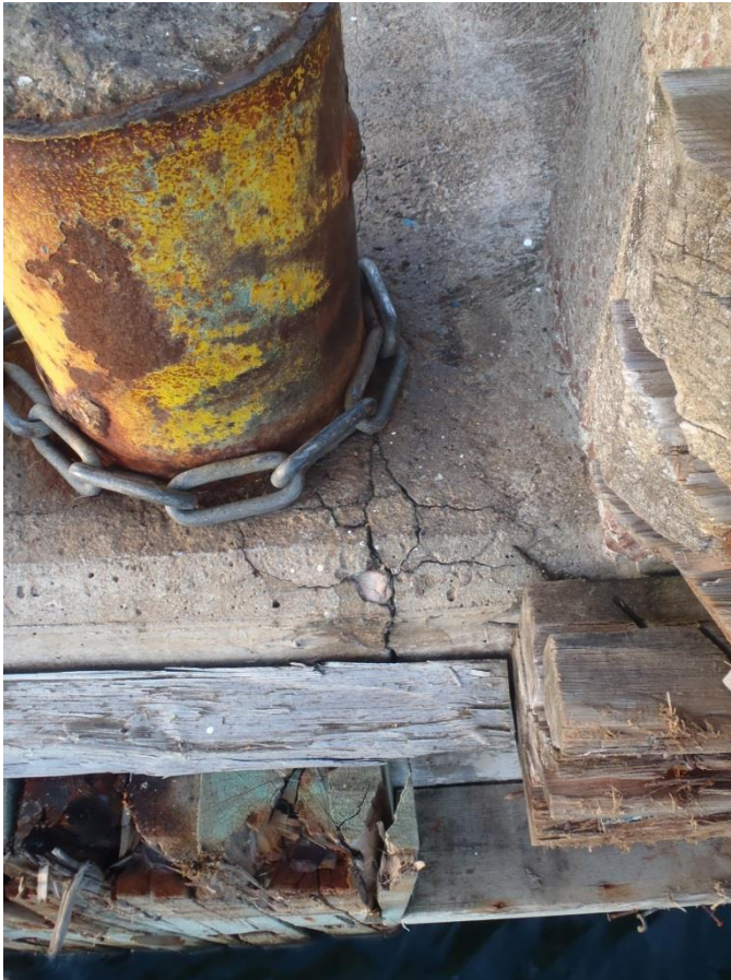
Bild 9: Spricka och betongskada vid pollare.
