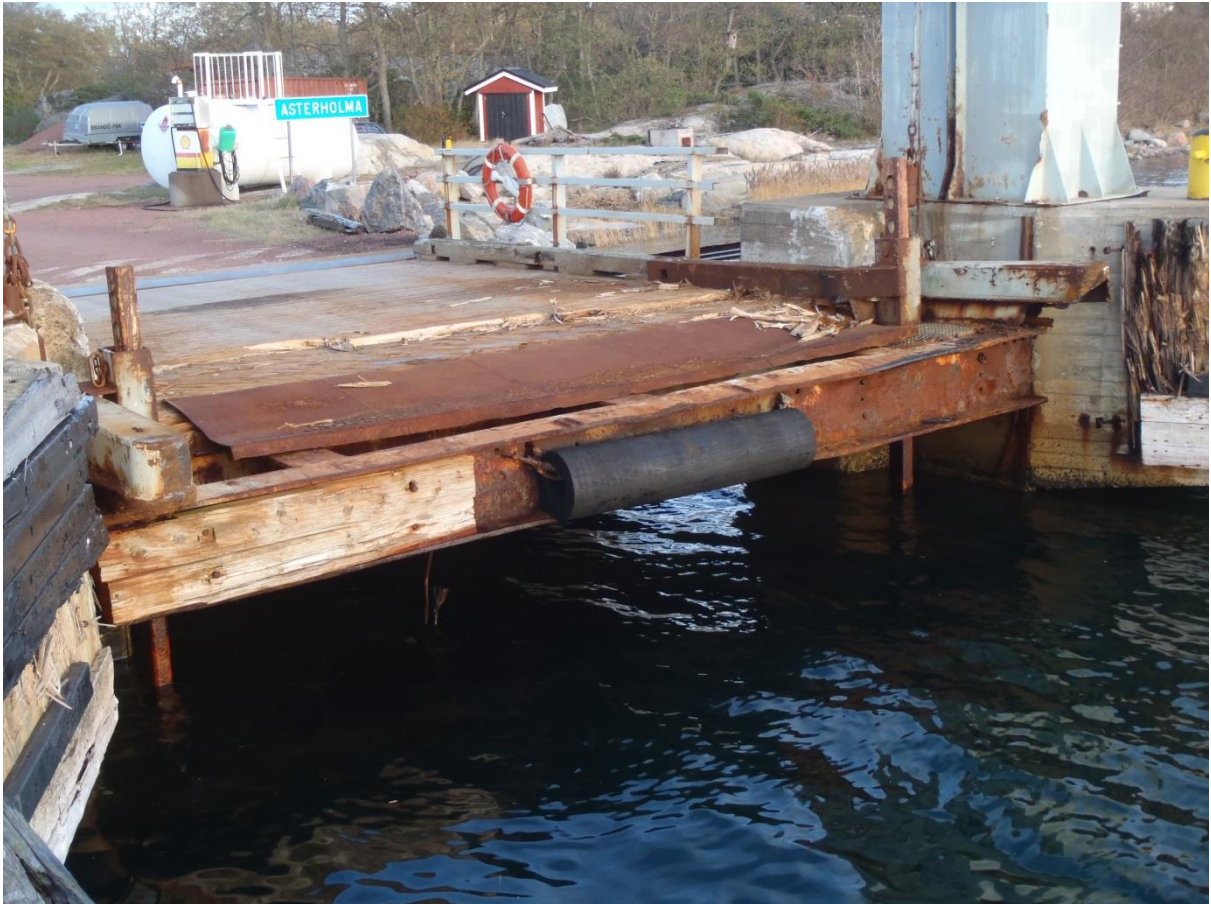
Bild 1: Korrosion i färjefästets balkar.
