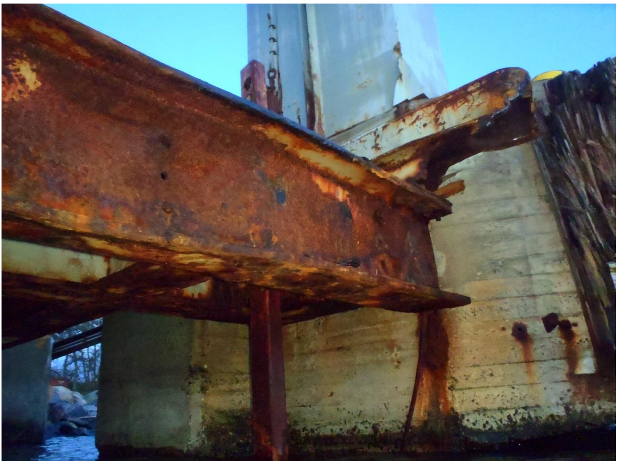
Bild 6: Korrosion i färjefästets balkar.
