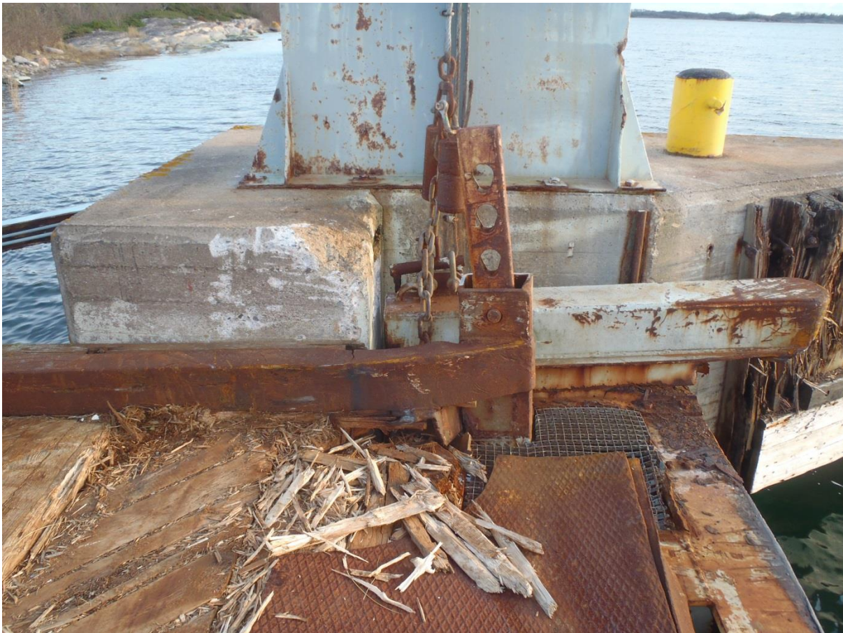
Bild 3: Korrosion i klaffens upphängning.
