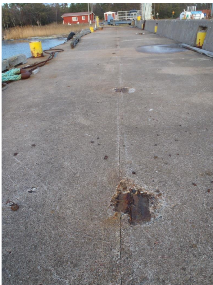
Bild 8: Armeringskorrosion och spjälkningar i pirdäck.
