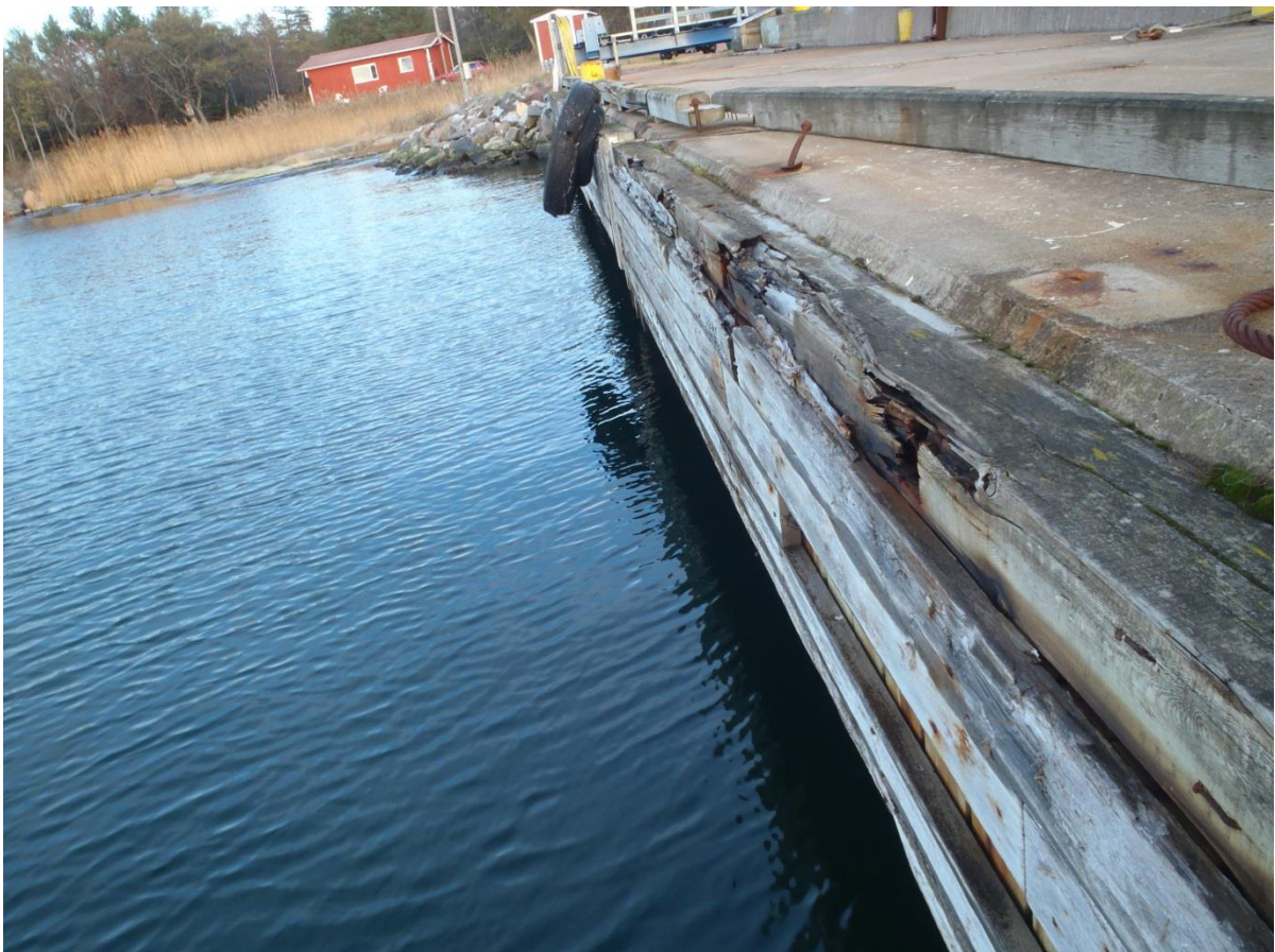
Bild 14: Skadad träinklädnad på piren.
