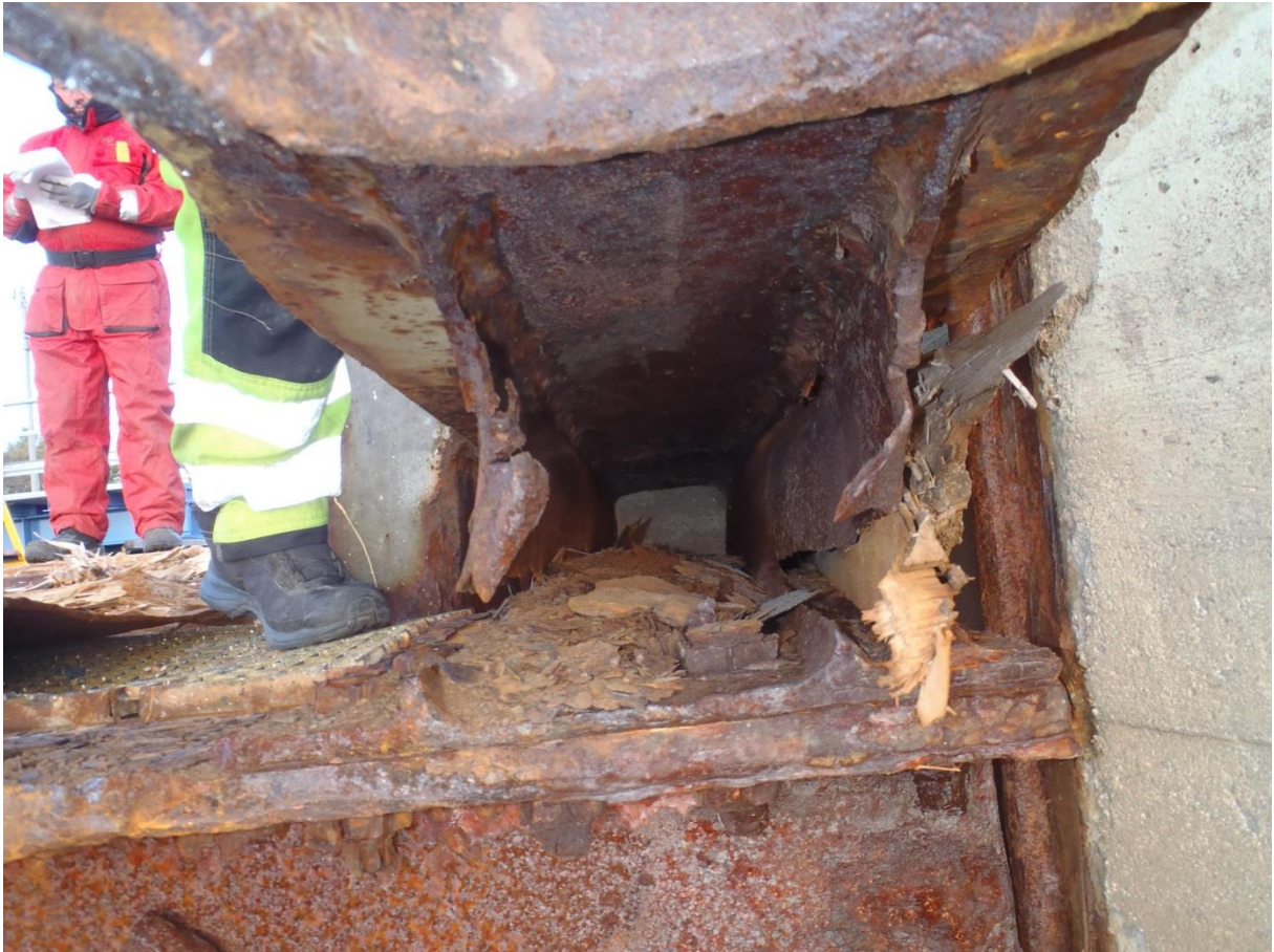
Bild 5: Korrosion i färjefästets balkar.
