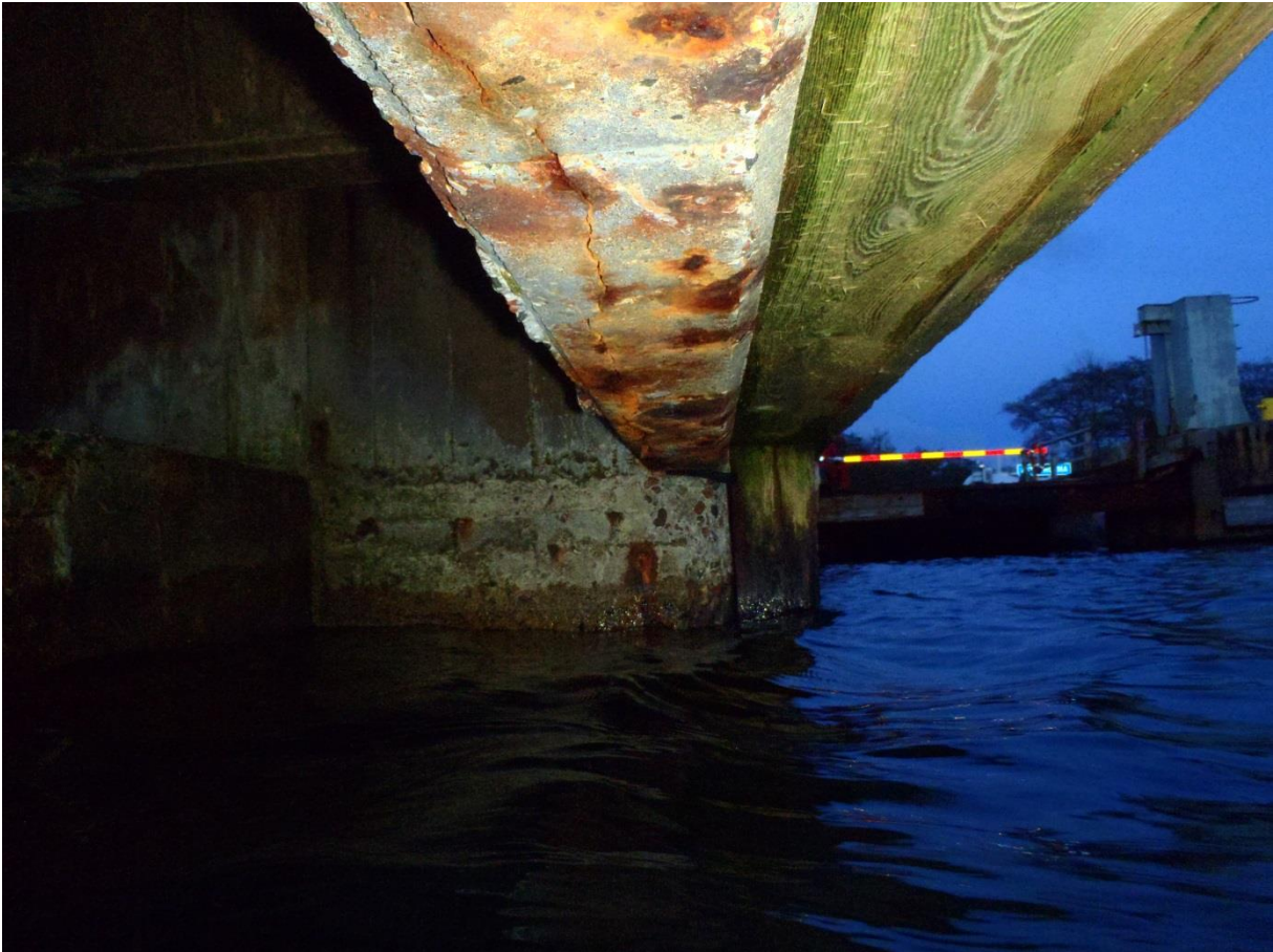
Bild 17: Armeringskorrosion och spjälkningar i pirdäckets huvud- och tvärbalkar.
