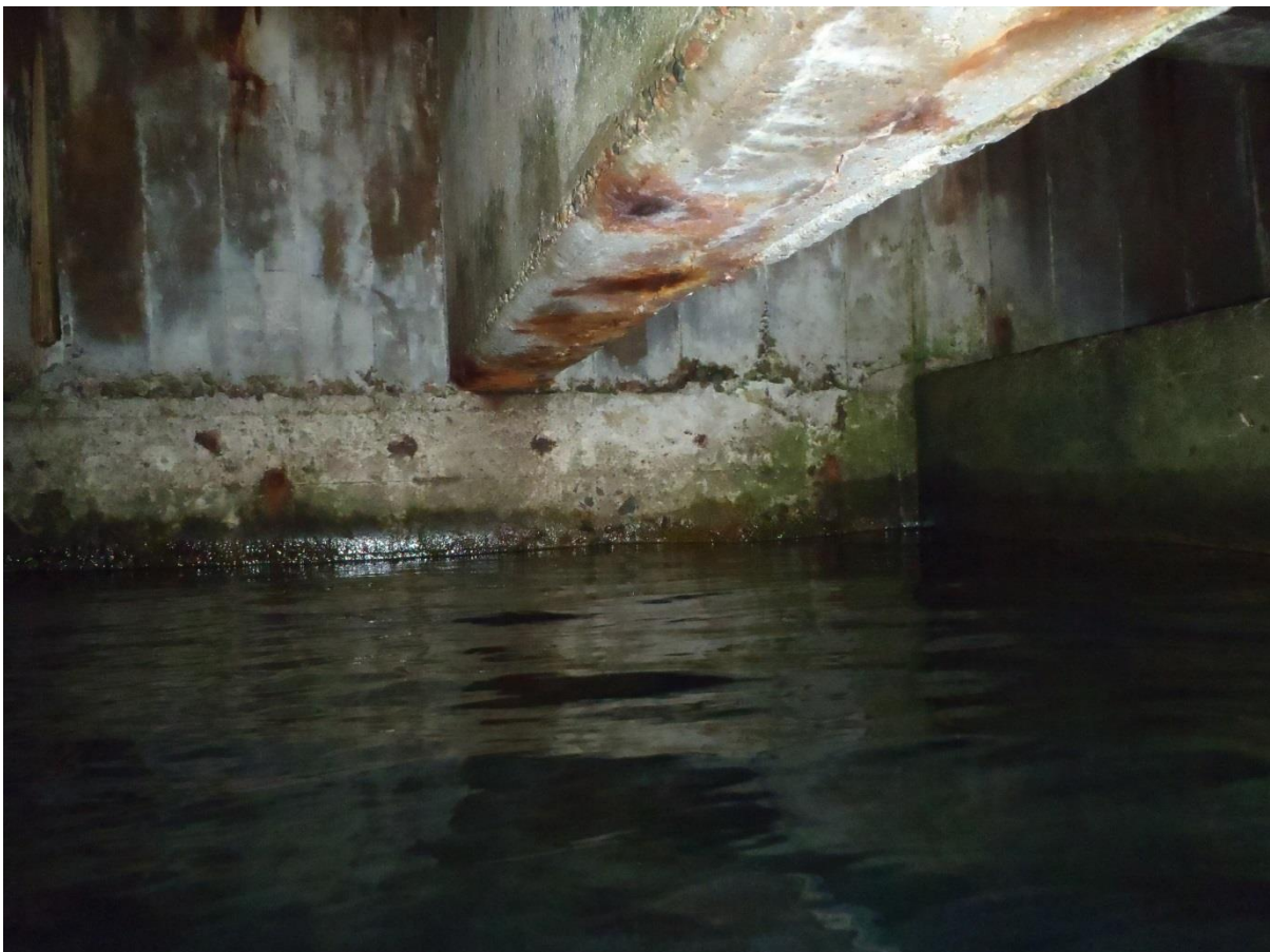
Bild 20: Armeringskorrosion och spjälkningar i pirdäckets huvud- och tvärbalkar.
